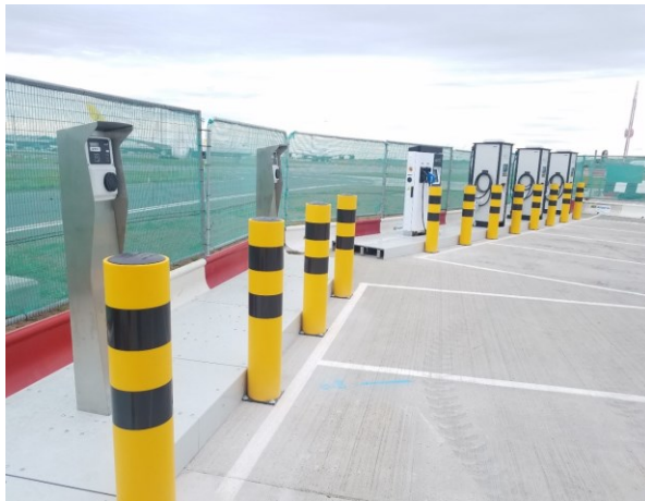
モジュール台座上に設置した充電設備の例
