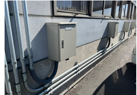
ビル壁面へのコンセントBOXの設置例 (羽田空港第2ターミナル)
