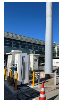
GPUキュービクルからの電力供給の例 (羽田空港第2ターミナル)
