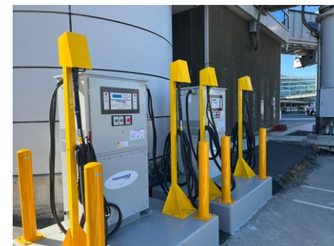
ターミナルビルからの電力供給の例 (羽田空港第2ターミナル)
