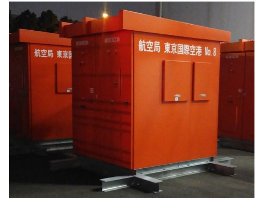
移動式受配電設備
