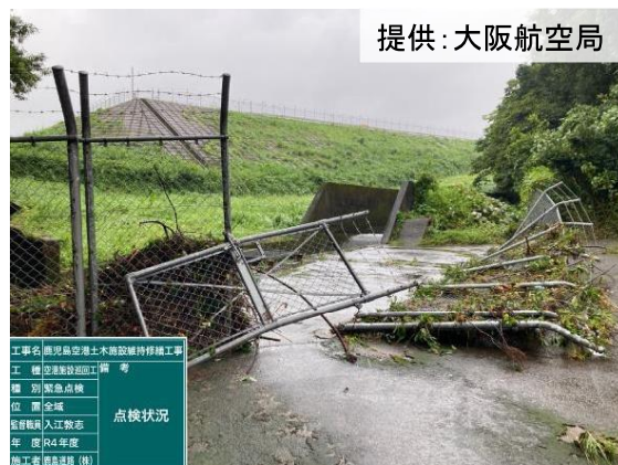
【② 敷地境界フェンス倒壊】
