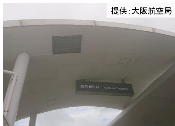
【横断歩道ルーフ・パネル破損、拡大】
