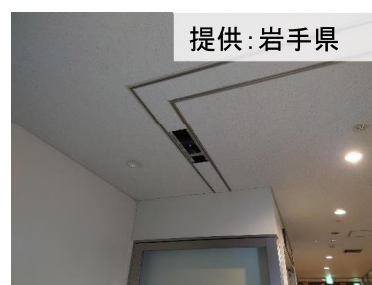
天井一部剥離
