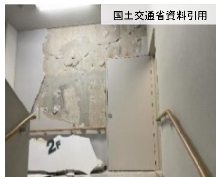
【 ターミナルビルの被災状況 】
