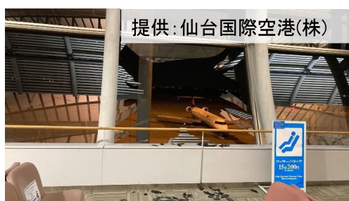
国内線ランドサイド窓ガラス破損
