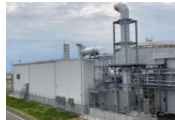
コージェネレーション システム更新 (2023年6月更新)
