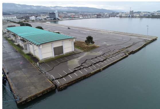
七尾港 被災状況調査
