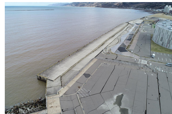
輪島港 被災状況調査
