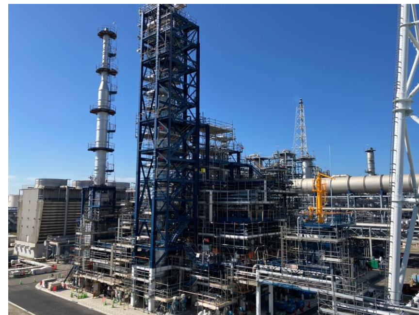
ニートSAF製造装置（左：加熱炉、中：蒸留塔）
