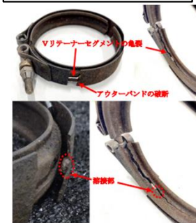
損傷したカップリング
