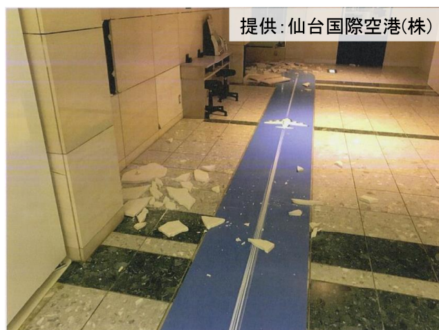
【仙台空港ターミナルビルの被災状況】
