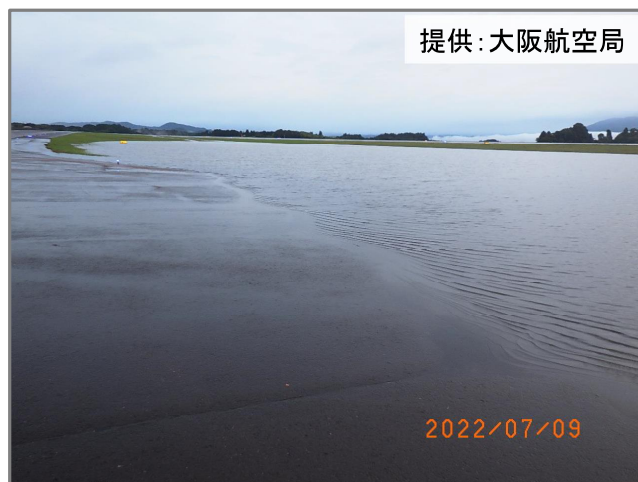
【T4誘導路の冠水状況】
