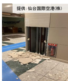
館内壁面破損
