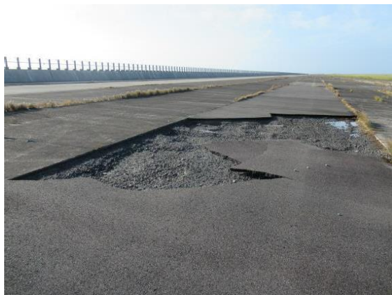
【③アスファルト舗装の剥離】
