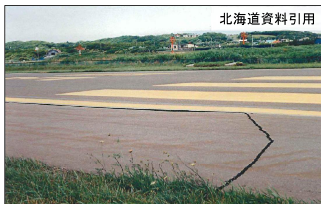
【滑走路に生じた亀裂の状況】
