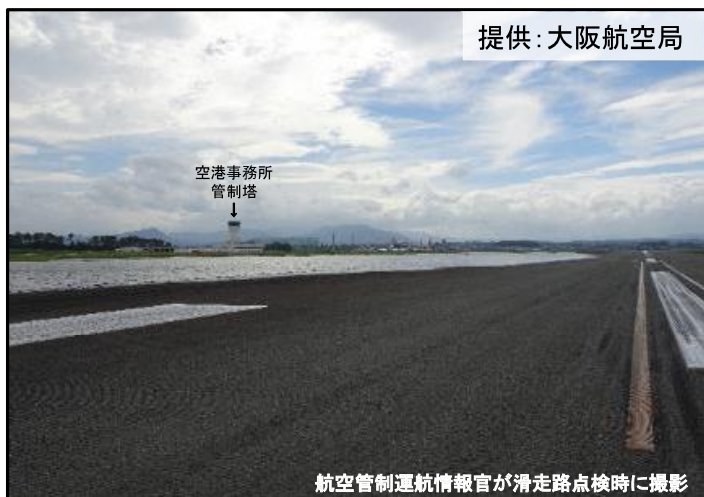
【滑走路点検時の冠水状況】
