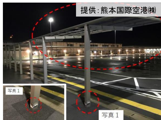
【④レンタカー乗降場の屋根及び支柱の破損】
