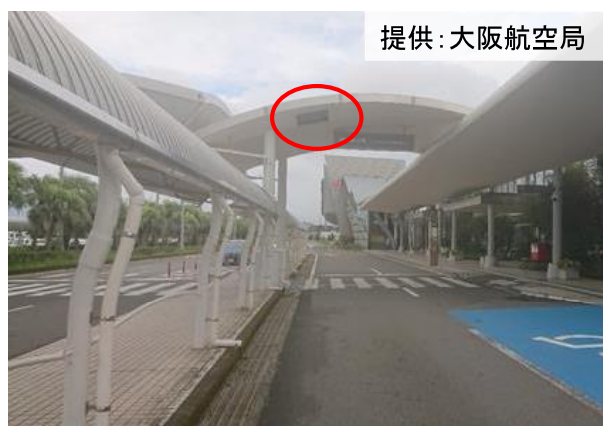
【横断歩道ルーフ・パネル破損】
