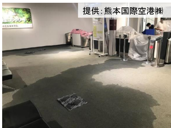
【①出発待合室の漏水】
