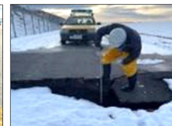
場周道路の陥没
