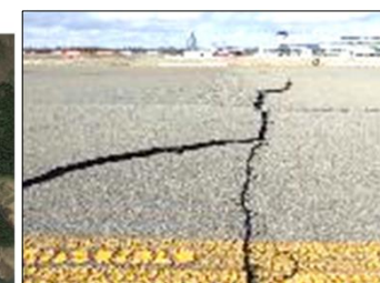
滑走路の亀裂
