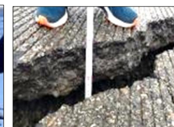
滑走路において最大15cmの段差
