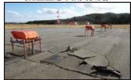
〈能登空港の被災状況〉
