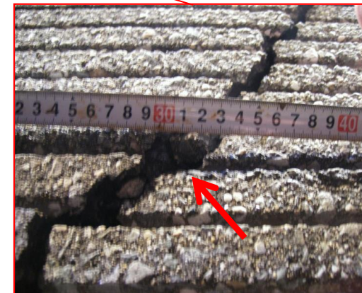
ひび割れ幅2cm以上
