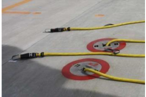
電力用ピット
