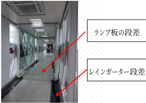
既存PBBトンネル内の段差
