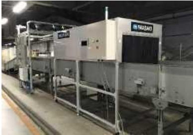
BHS内荷物用除菌装置
