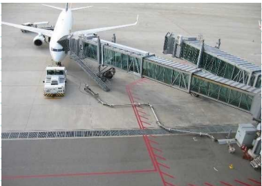
電力供給の様子
