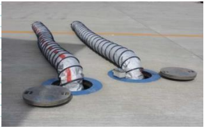
エアコン用ピット
