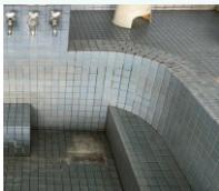
男子共同風呂 (タイルの剥がれ)
