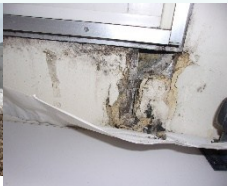
寮室(内壁の損傷、 壁に断熱材が入って いない部屋がある)
