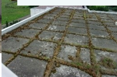
運管局舎(屋上 防水の劣化)
