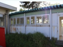
学生寮外壁(錆)
