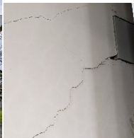
教室内壁 (ひび割れ)
