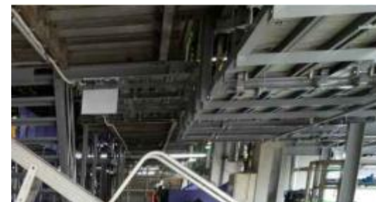
既存インフラ・設備との干渉となる例 （羽田空港内ソーティングエリアの階段・キャットウォーク）
