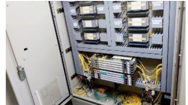
拡張が必要となる電気・通信設備のイメージ
