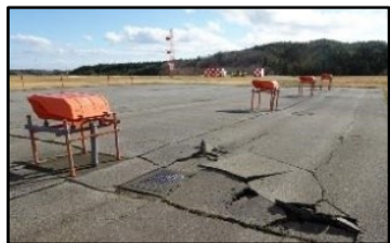
〈能登空港の被災状況〉
