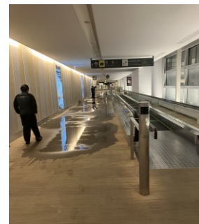
ビル漏水状況
