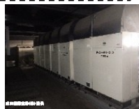
高効率型空調機
