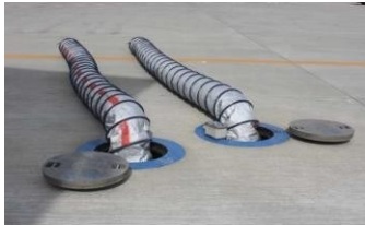
エアコン用ピット
