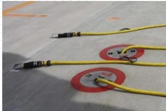
電力用ピット
