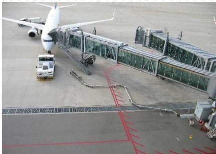
電力供給の様子
