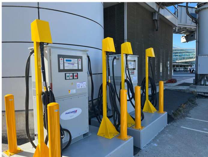
固定橋ロタンダ付近の設置事例 (東京国際空港第2ターミナル)
