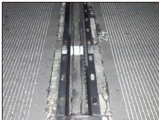
①5/29 破損箇所
