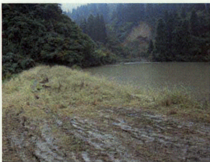
3. びわ崎池の堤体上流側の損傷(沈下)
