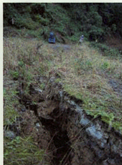
4. びわ崎池の堤体天端に発生した大きな亀裂
