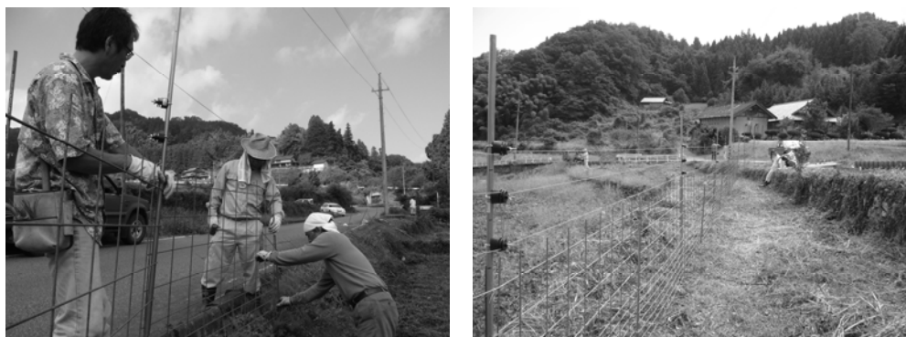
図表4-2-13 鳥獣被害防止柵の設置状況
