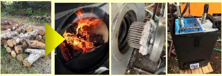
実証試験状況(薪ボイラー、スターリングエンジン、蓄電池)
