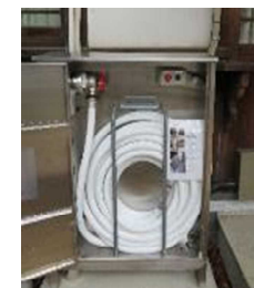
（易操作性1号消火栓） 初期消火、火災の拡大を防ぐための 消火栓設備 等
