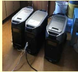
家庭に設置した蓄電池
