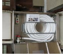
(易操作性1号消火栓)
