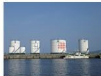
・ 離島の油槽所
