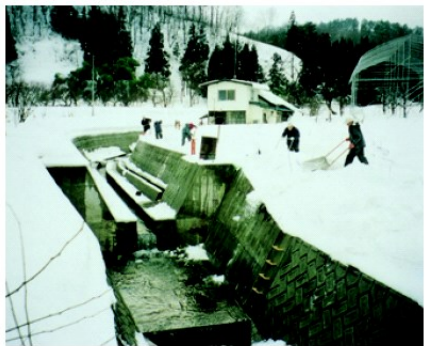
除排雪低水路(山形県村山市)
