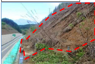
写真① 表層崩落状況
