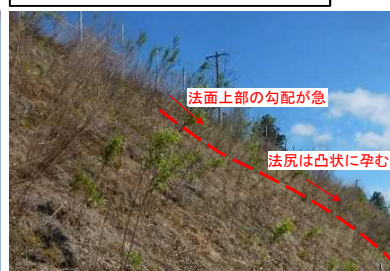
写真② 孕み出し状況
