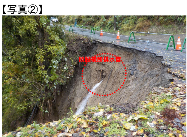
令和7年11月10日撮影(被災状況)
