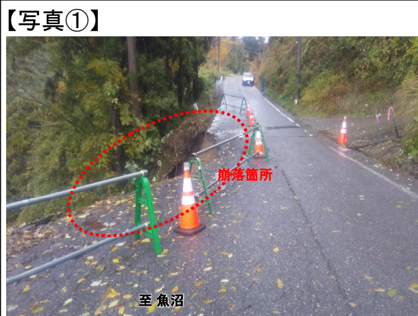
令和7年11月10日撮影(被災状況)
