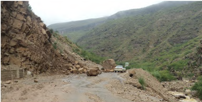
被害に遭った道
