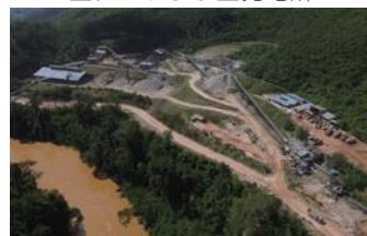
骨材生産プラント
