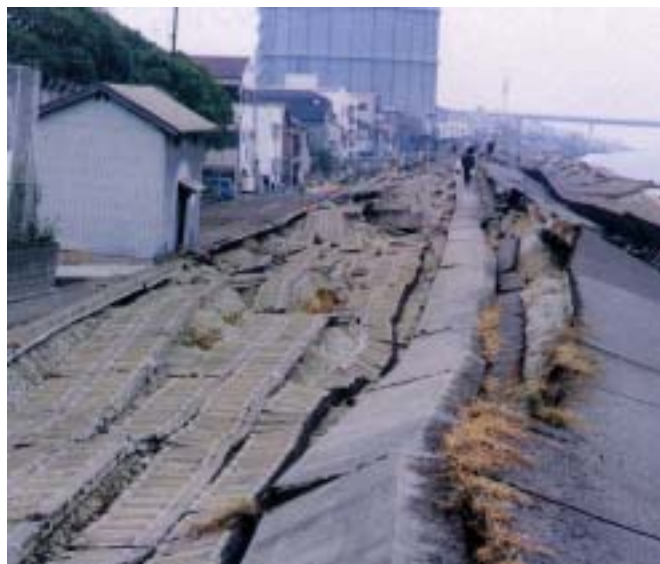
地震による堤防の被災状況
