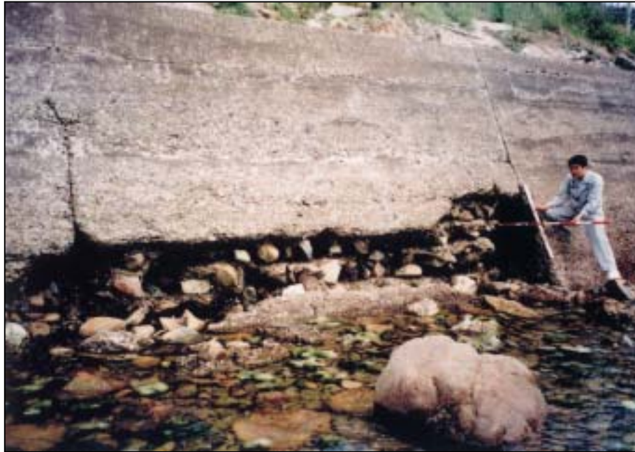
老朽化した護岸の状況（兵庫県阿那賀海岸）
