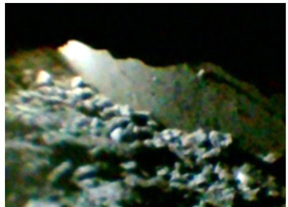
例) 詳細調査による空洞確認
