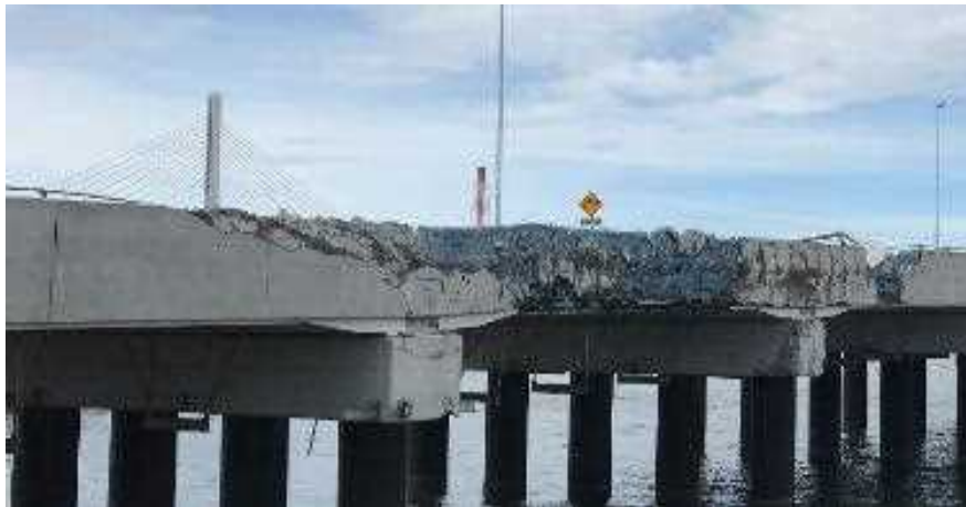
＜横浜港 南本牧はま道路の損傷＞
