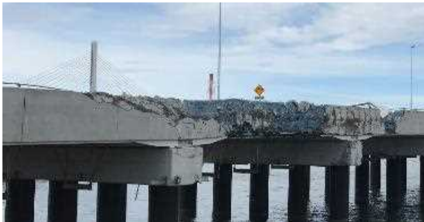
<横浜港 南本牧はま道路の損傷>
