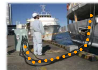
電力供給設備
