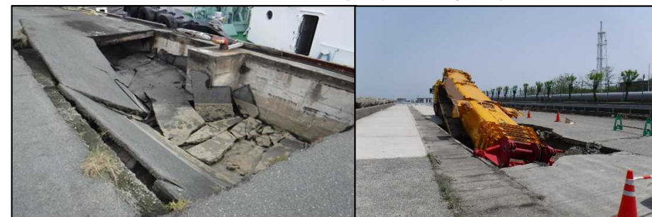
老朽化の進行による港湾施設の破損・事故例
