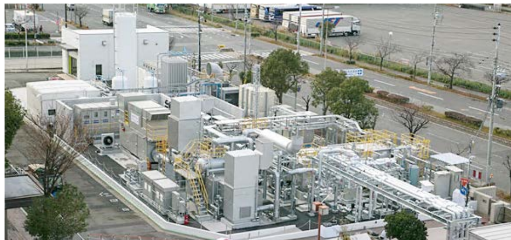
実証プラント（出所：NEDO HPより）
