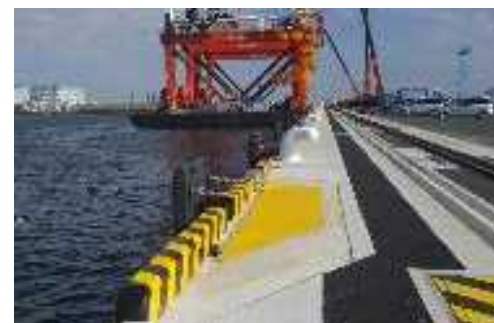
岸壁際のコンセントボックス（例）
