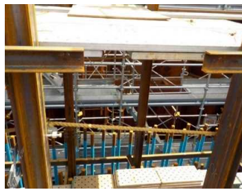
写真-2 架台落下箇所
