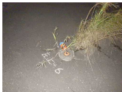
誘導路灯破損状況
