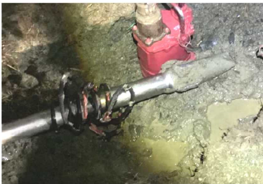
埋設ケーブル損傷写真
