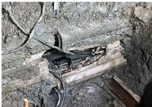
高強度多孔陶管損傷状況
