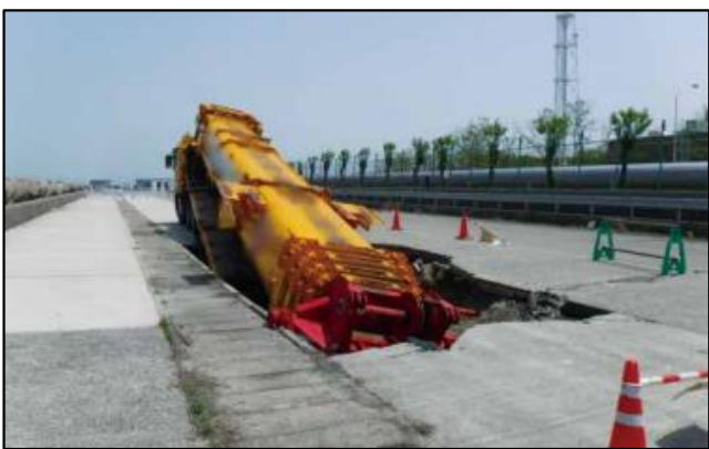
埋立護岸による陥没の発生状況
