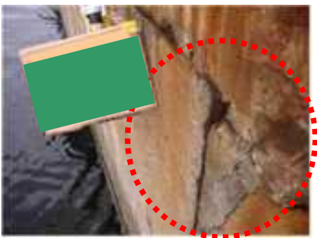
写真 4-03：劣化度判定『b』
