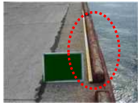
写真 7-02：劣化度判定『c』
