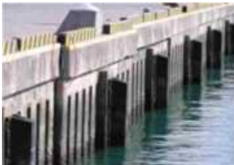
写真 1-03：劣化度判定『b』
