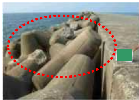
写真 4-02：劣化度判定『b』
