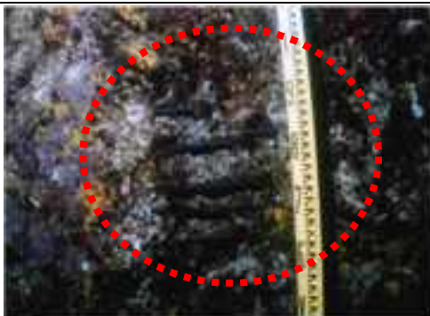
写真 3-02：劣化度判定『a』
