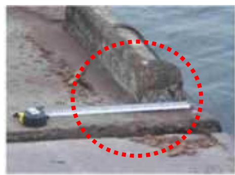
写真 7-02：劣化度判定『c』
