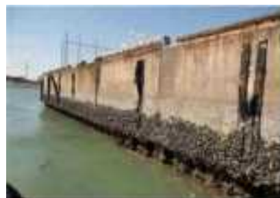
写真 3-7.2 防衝設備の変状の事例
