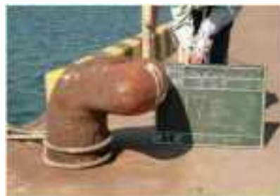
写真 3-7.1 係船柱の変状の事例
