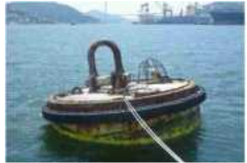
写真 3-6.3 係船浮標の外観
