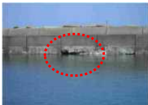
(コンクリートブロックの欠損)
