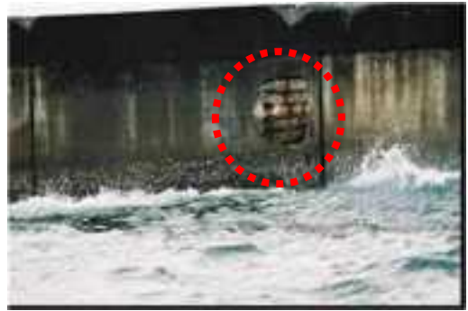
写真 2-02：劣化度判定『a』
