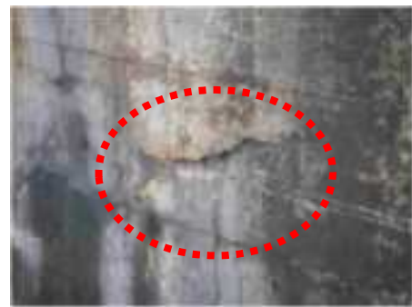
写真 4-02：劣化度判定『b』
