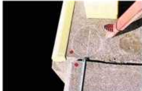
写真 1-02：劣化度判定『b』
