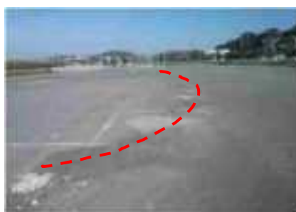
写真 3-6.2 エプロンの沈下、陥没
