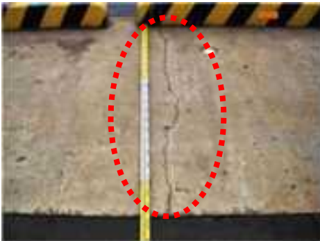
写真 4-01：劣化度判定『b』
