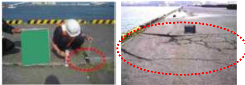
写真 3-2.2 エプロンの変状の事例
