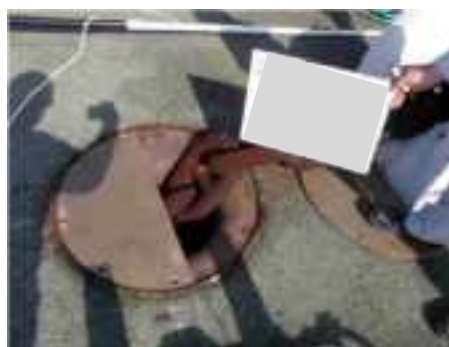
写真 3-5.2 チェーンホール
