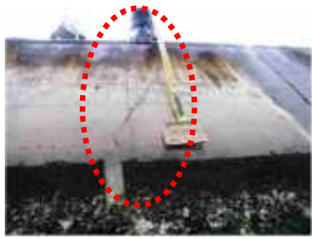
写真 4-04：劣化度判定『b』
