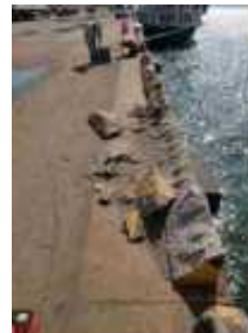
写真 3-7.3 車止めの変状の事例
