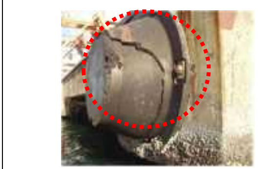
写真 5-04：劣化度判定『a』
