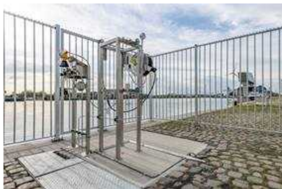
図 9: 水素ステーション(船舶用充填設備部分)
