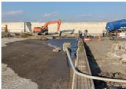
既設水道管損傷 (遠景)
