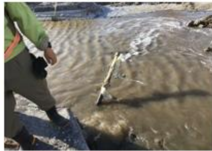
既設水道管損傷 (近景)
