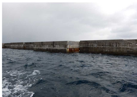
ケーソンの港内側への滑動
