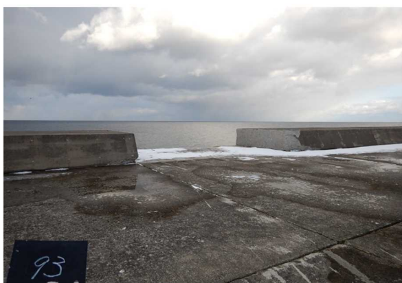
上部工の欠損
