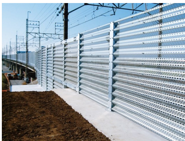
図表 5-6 防風柵／防塵柵・防砂柵／防雪柵
