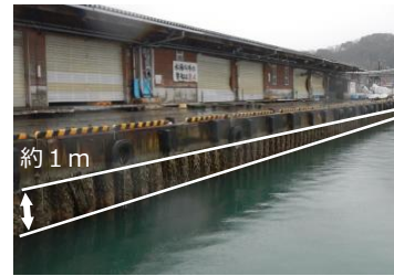
地盤の隆起による水深不足(輪島港)
