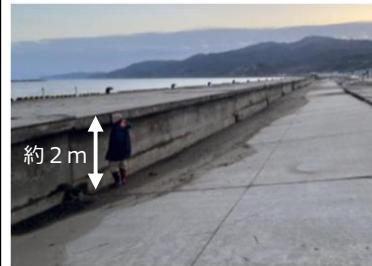
岸壁背後の沈下(輪島港)
