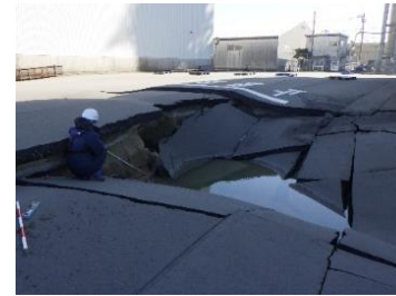
ふ頭用地の陥没(金沢港)
