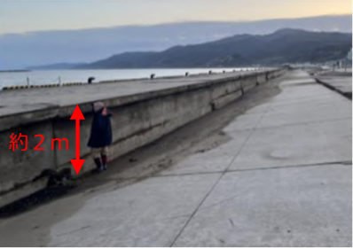
岸壁背後の沈下(輪島港)
