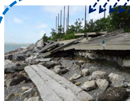
高波による護岸損壊
