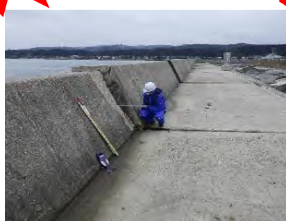
地震による護岸の倒壊
