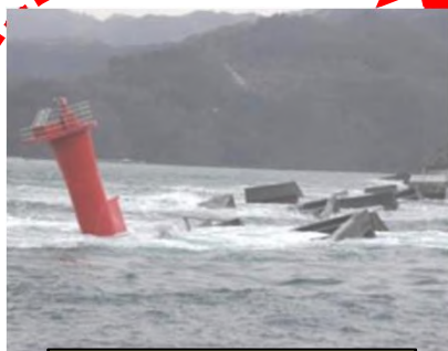
防波堤の損壊
