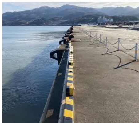
岸壁本体の被災状況
