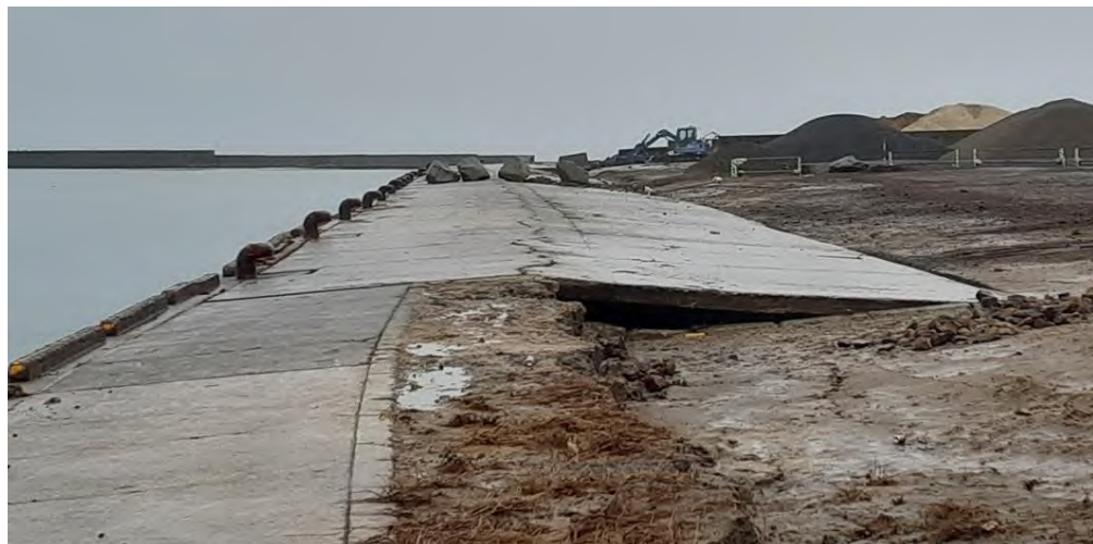
水深4.5m岸壁の被災状況
