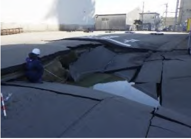
ふ頭用地の陥没(金沢港)
