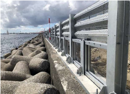
【設置状況（海側から見て）】
