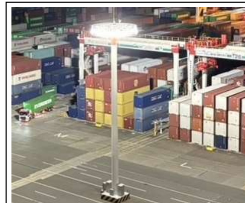
ヤード照明のLED化（全10基）
